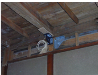
木造住宅の天井裏設置事例
